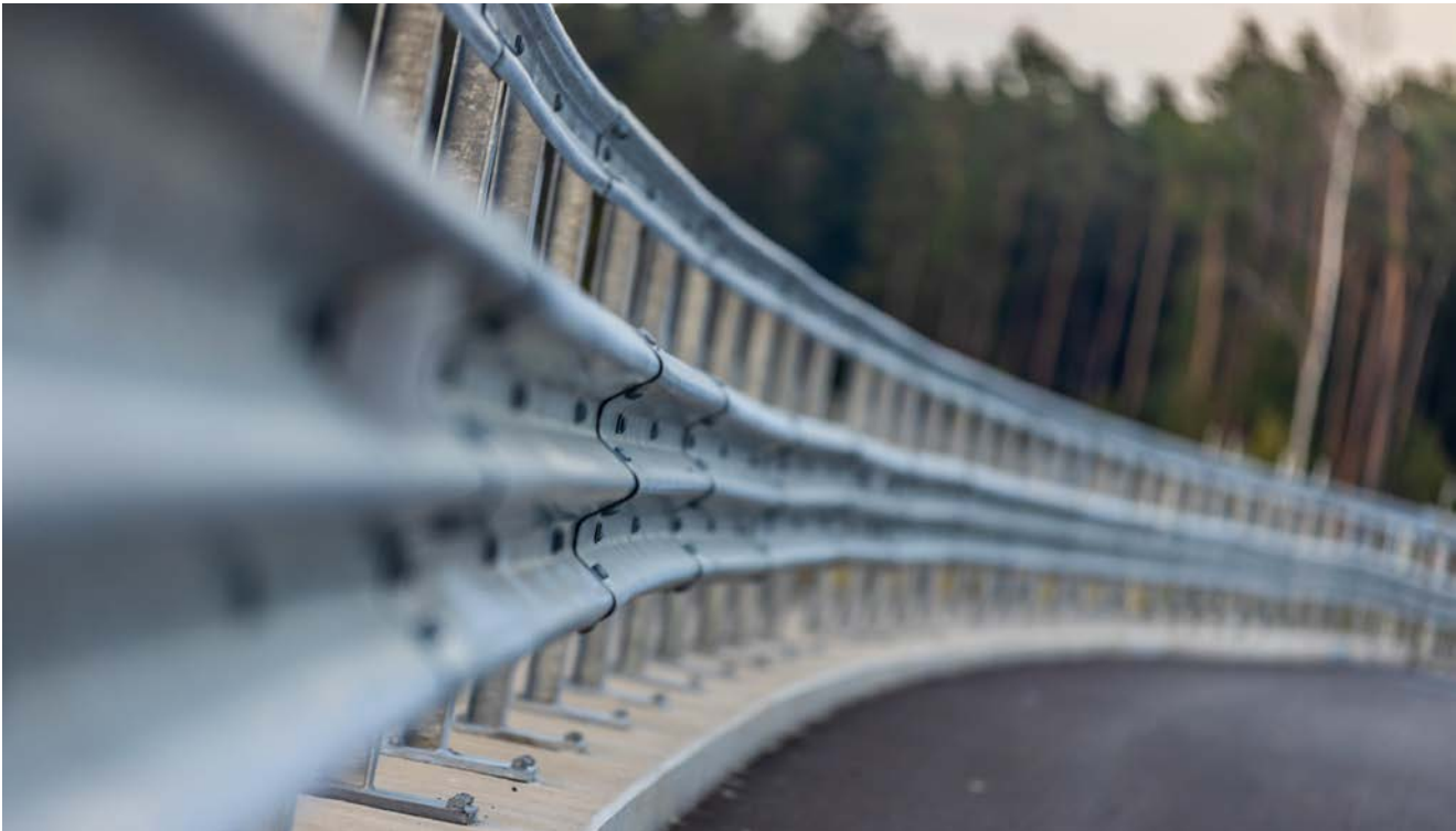
Abbildung 19: Rückhaltesystem entlang der Autobahn, Bild: ASFINAG
