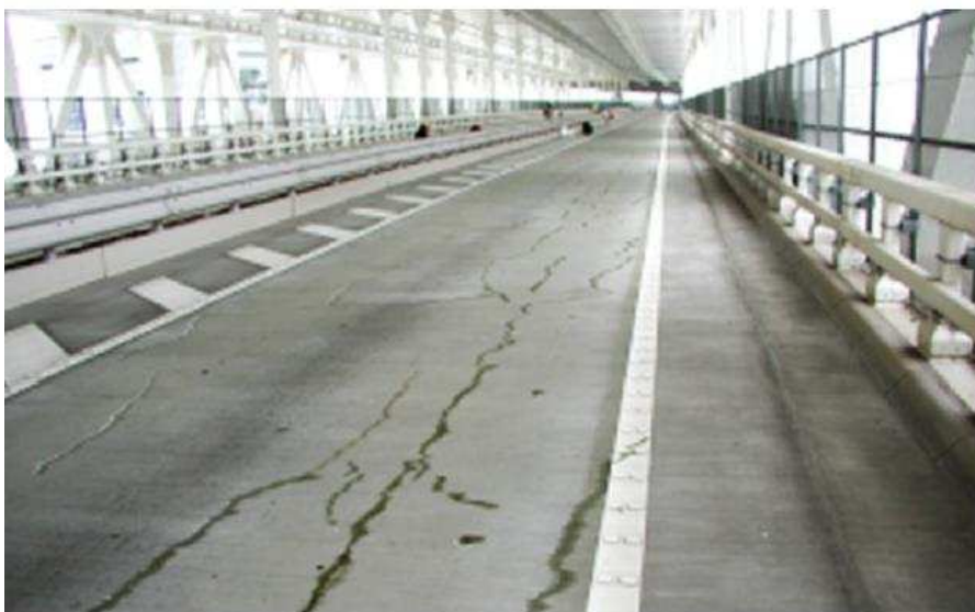
Abbildung 3.24: Risse in der Fahrbahnoberfläche der YBB [24]
