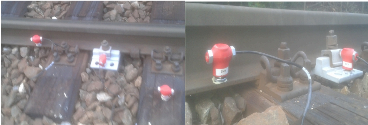
Abbildung 21: Übersicht über die verschiedenen Montagepunkte. Geophon 1 ist auf dem Schweller geklebt, Geophon 2 ist auf die Schiene geklemmt mit einer Schienenklemme und Geophon 3 ist auf die Schiene geklebt, Daten siehe Abb. 22, ÖBB Strecke Hieflau-Eisenerz, km 3.450, Jägerkogel.
