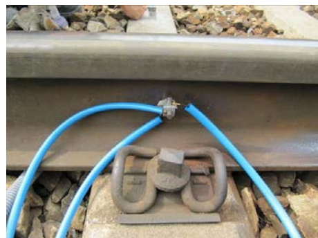
Foto 12. Beschleunigungssensor am Gleis
