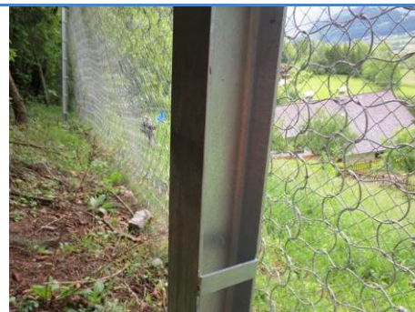
Foto 22. Stahlsteher eines Steinschlagnetzes
