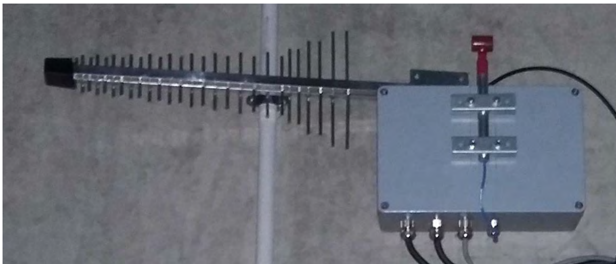
Abbildung 48: Datenerfassungseinheit mit zusätzlicher Richtantenne und aufgesetztem Anemometer (rot)
