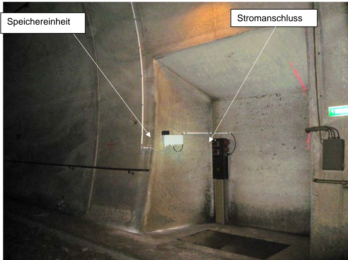
Abbildung 93: Positionierung der Speichereinheit und Stromversorgung
