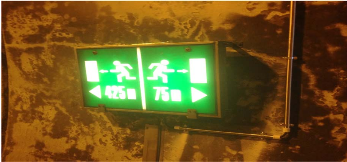
Abbildung 95: Kabelführung zum Fluchtwegweiser
