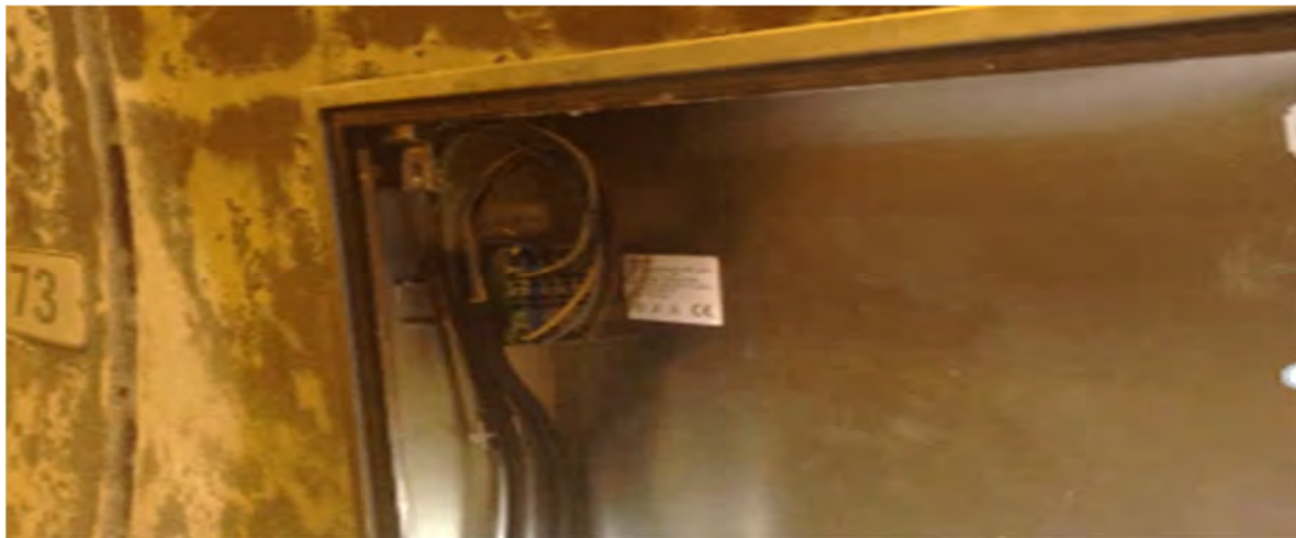
Abbildung 8: Anschluss an das Stromnetz
