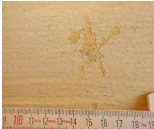
a) Krakeleerisse im Wolfsbergtunnel – RFB Salzburg
