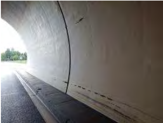
a) Unfallschaden Tunnelanstrich
