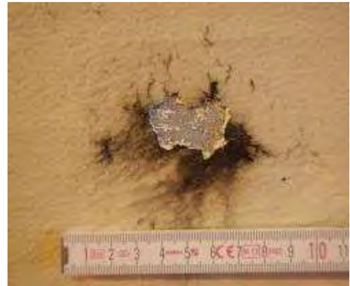
b) Schwarze Verfärbung im Wolfsbergtunnel – RFB Salzburg
