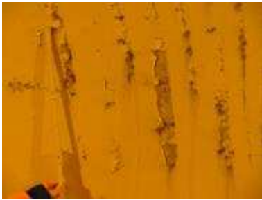
a) Längliche vertikale Schäden im unteren Bereich
