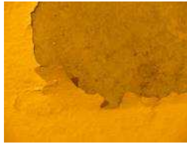
b) Großflächige Abplatzungen im oberen Bereich
