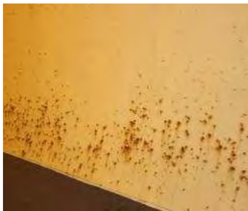
a) Rostpunkte im unteren Bereich
