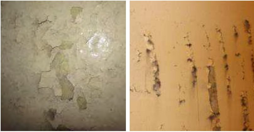
a) Krakeleerisse im Ganzsteintunnel b) Abplatzungen im Strenger Tunnel ABB 2. Schäden aus realen Tunnelbauwerken
