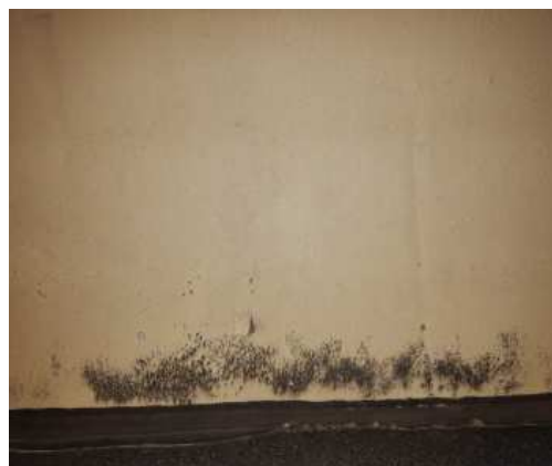
Abbildung 55: Schmutzbelag im Sockelbereich im Mitterbergtunnel – RFB Klagenfurt
