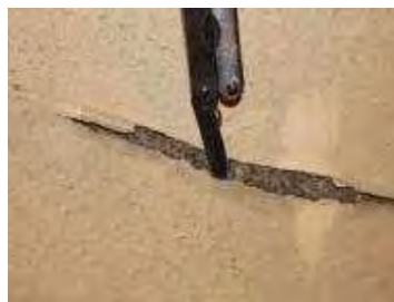
b) Beschädigte Beschichtung aufgrund eines Unfallschadens
