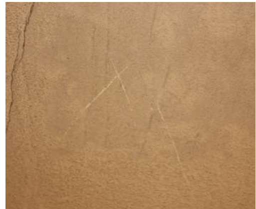
b) Dunkle Schatten mit schlechter Haftung im Flirscher Tunnel
