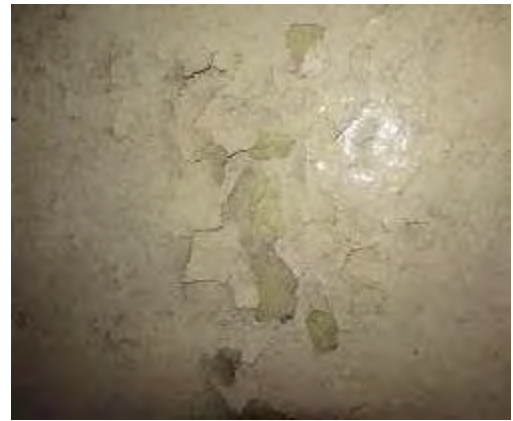
b) Krakeleerisse im Ganzsteintunnel
