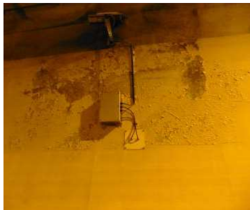
a) Schaden bei Einbauten
