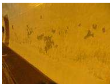
b) Abplatzungen entlang der Tunnelwand
