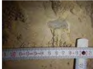
b) Abplatzung bis zum Beton mit pulveriger Spachtelmasse
