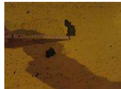
c) Abplatzung (Detailansicht)
