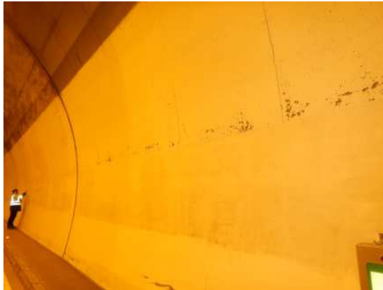
Abbildung 47: Schäden beim Systemübergang im Mitterbergtunnel – RFB Klagenfurt
