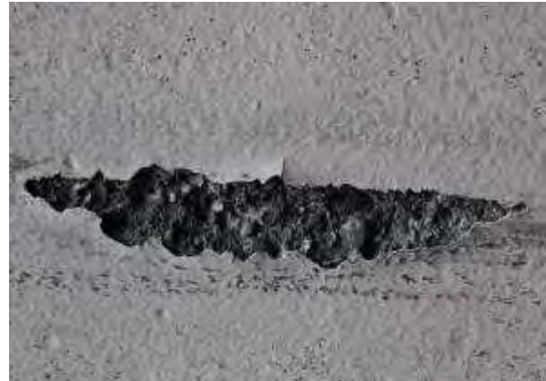
d) Detailansicht mit zerstörtem Betongefüge
