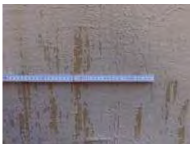
a) Vertikale Abplatzungen im Portalbereich
