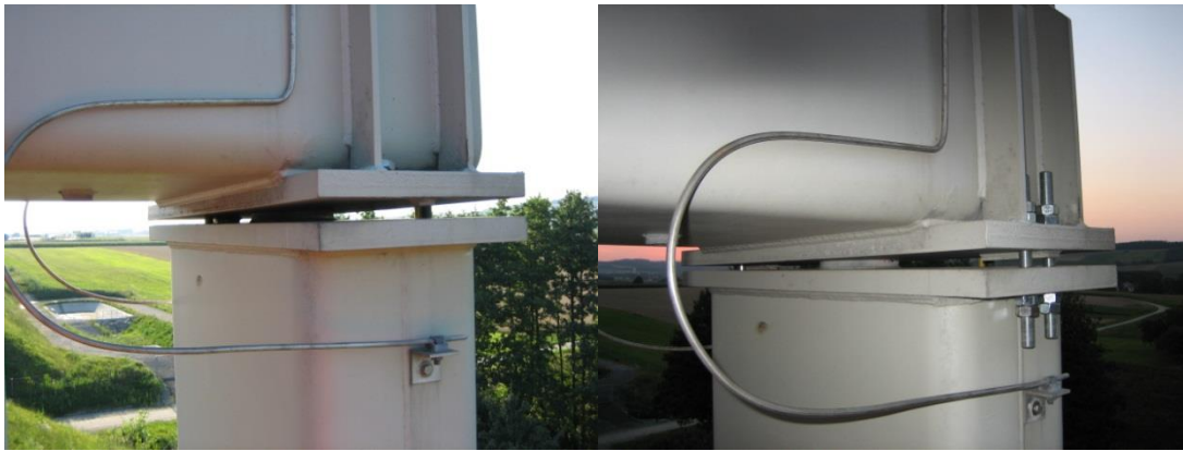
Abb. 2-4. Schadensstelle. Links: Vorgefundene Situation bei Wartung. Rechts: Provisorische Lösung. Fotos: [10]
