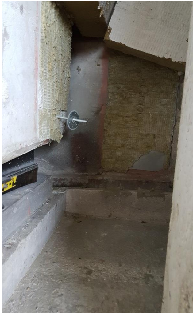
Abbildung 5-53: Die Dämmmatten im Bereich der Auflagerbank konnten seitlich (hochgezogen) nicht zur Gänze entfernt werden (14.10.2016)
