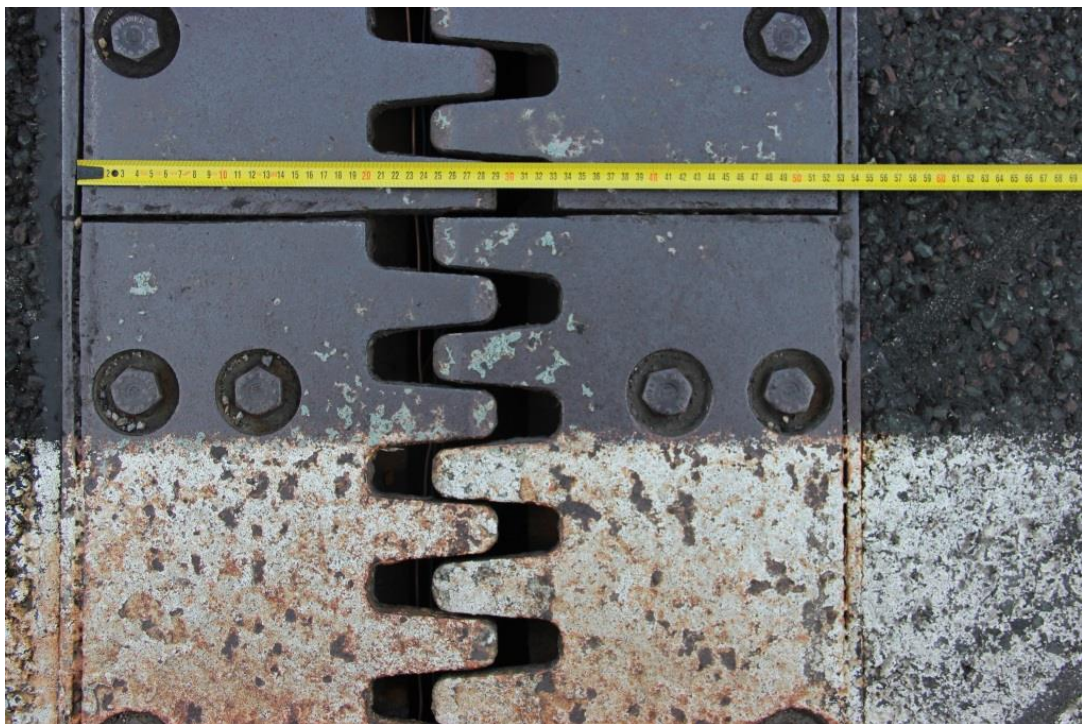
Abbildung 5-2: FÜK (Fingerübergang-auskragend), A10, km 141. Öffnungsbreite: 13cm / DL = 55,1cm, 17.11.2015
