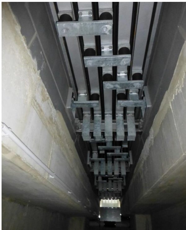
Abbildung 5-28: FÜK (Trägerrostdehnfuge mit 2 Randprofilen und 5 Mittelträgern), S34, km 24,3 Objekt 6781F3
