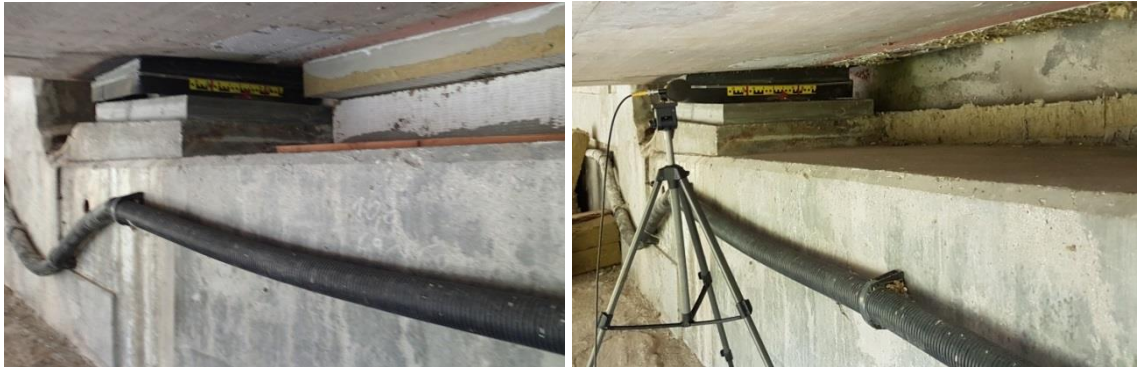
Abbildung 5-49: Mit Dämmmatten (Links) / ohne Dämmmatten (Rechts)
