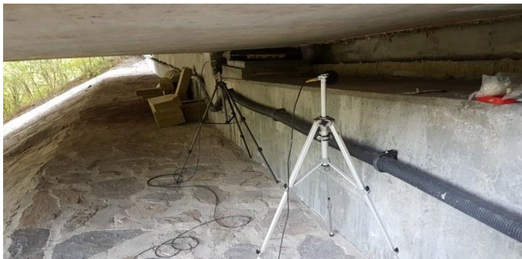
Abbildung 5-52: Messort A 21, km 19,57, Messpunkt im Übergang ( d=3,75\text{m} / h=1,2\text{m} ) sowie Messpunkte unter der Brücke (Zustand ohne Dämmmaterial am 14.10.2016). Die Dämmmatten wurden unterhalb von FS1 temporär entfernt.
