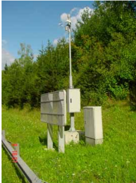
Abbildung 20: ASFINAG-Messstelle (Quelle: ASFINAG / W. Seidl)
