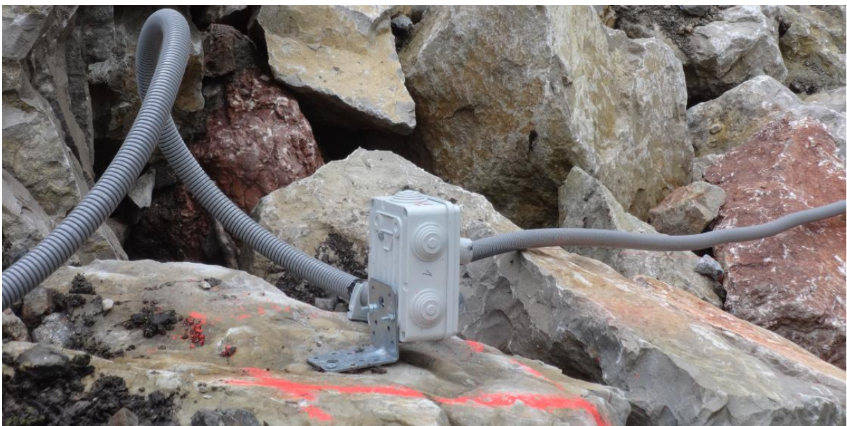
Abbildung 31: Wegaufnehmer zur Überwachung eines Kriechhanges an der Bahnstrecke
