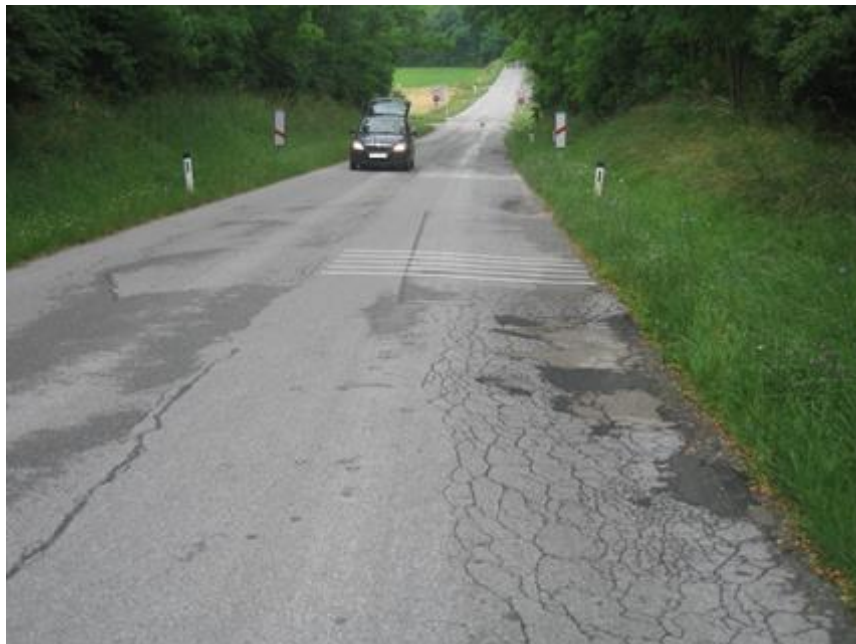
Abbildung 18: Fahrbahnschäden auf der Teststrecke Raggendorf, Richtung Raggendorf
