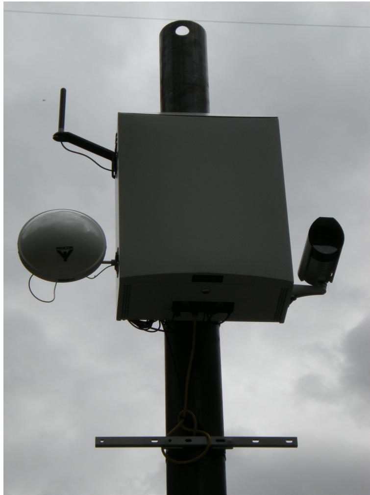
Abbildung 9: Versuchsanlage Lattenbach mit Antenne, UMTS-Antenne, Schaltschrank und Videokamera
