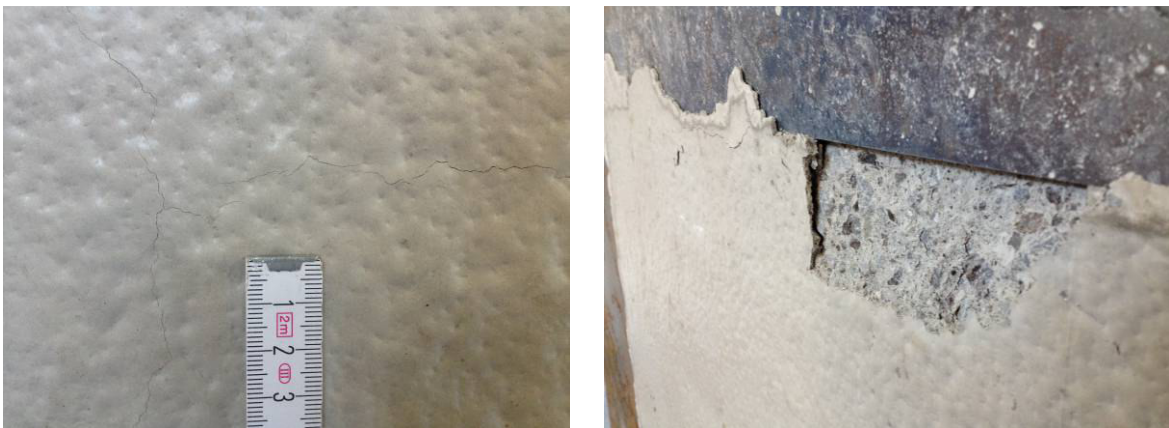
Abbildung 115: links: feine Risse an der Oberfläche des Beton. Rechts: Ablösungen des randlich unterlaufenen Zementsteins bis etwa 1 cm Tiefe.
