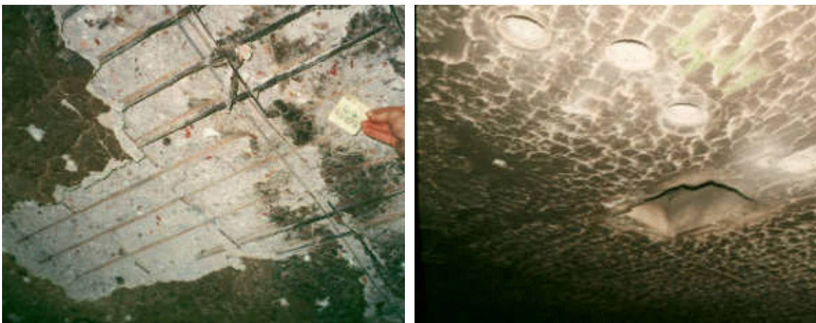
Abbildung 8: Zwischendecke „stark geschädigt“ (links) und „gering geschädigt“ (rechts) [12]
