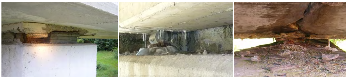
Abbildung 5 typische Schäden an Brückenlagern
