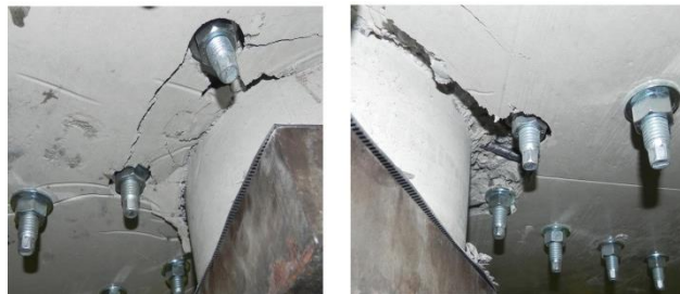
Abbildung 3.7: Lokales Betonversagen unter den Unterlegscheiben
