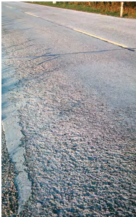
Abbildung 4: Frostschäden an einer ohne künstliche Luftporen hergestellten Betondecke [Foto VÖZFI]
