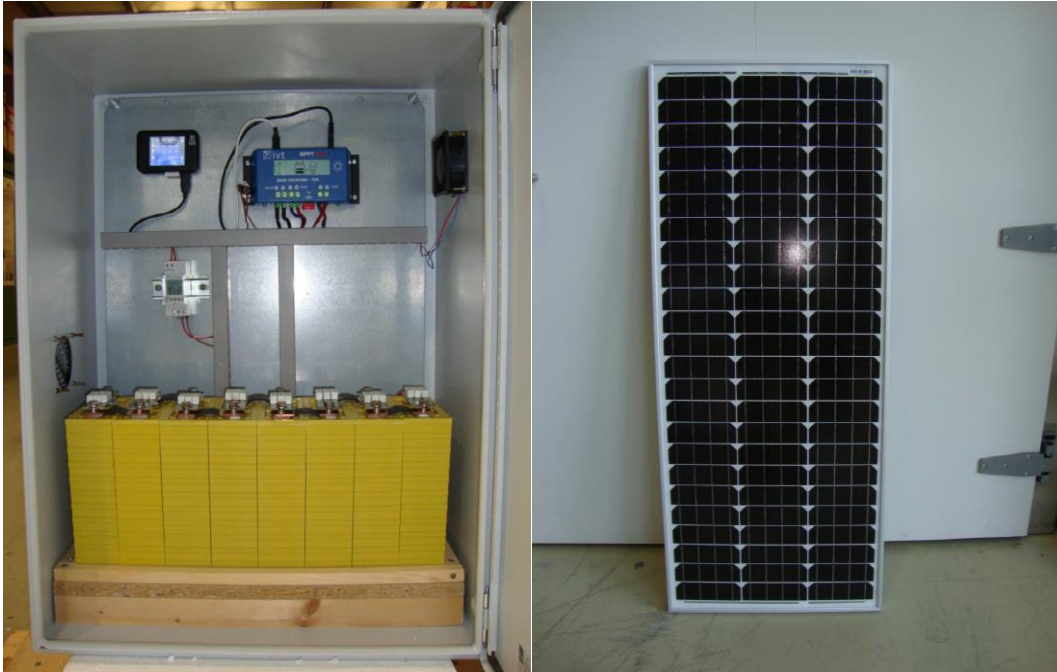
Abbildung 35: Schaltschrank (AIT Prototyp für interne Vortests)
