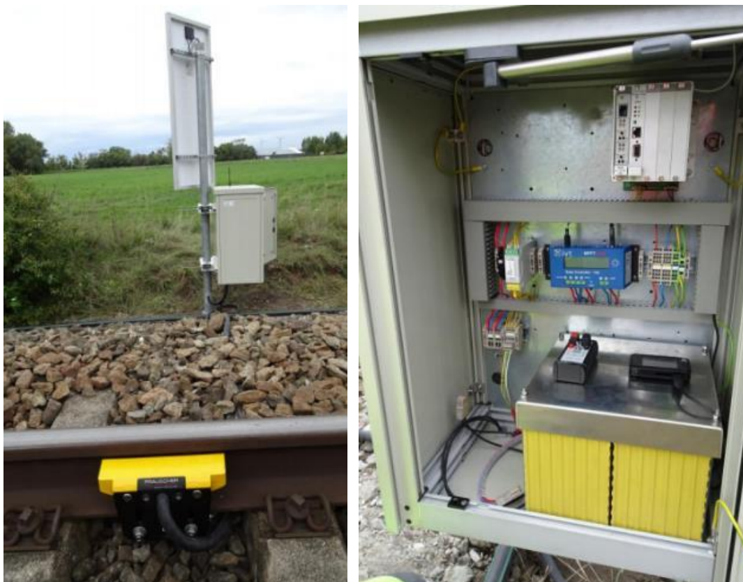
Abbildung 14: Testaufbau Lophonode km 29,195 (RSR, Auswertung RSR, Umsetzungsbaugruppe und Energieversorgung)
