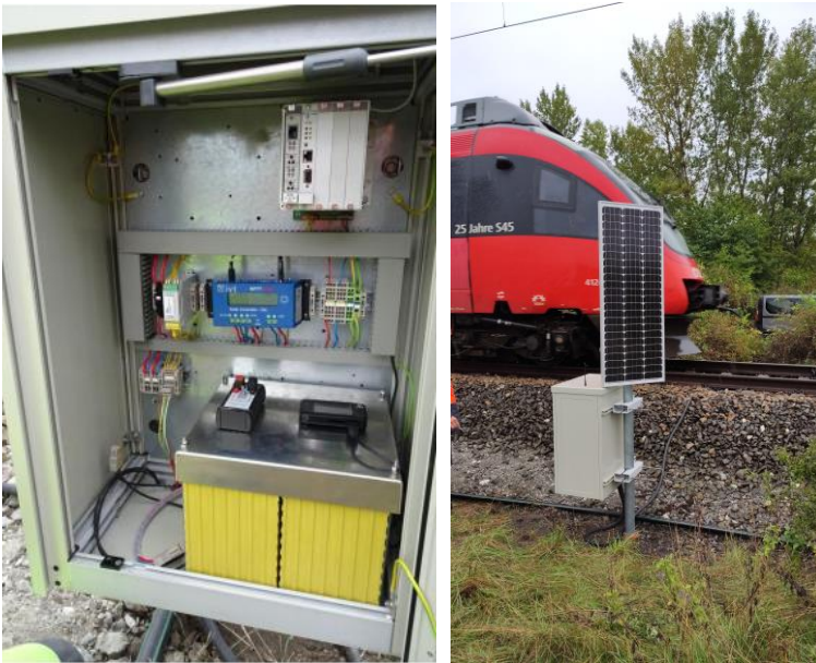
Abbildung 2: Schaltschrank mit Solarpanel, Auswertung, Umsetzbaugruppe und erstem Funkknoten
