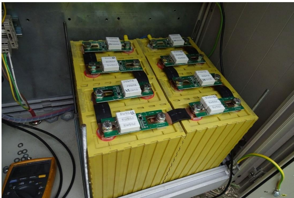
Abbildung 36: Batteriemangement und Batterie im Outdoorschrank
